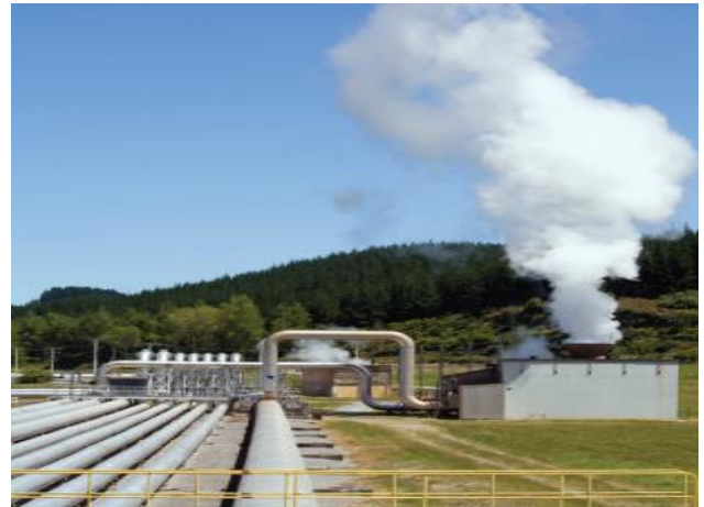
Şekil 2. Jeotermal enerji santrali (16)
