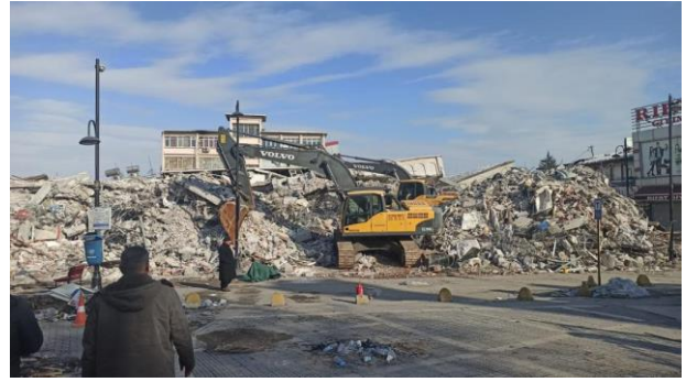
Şekil 4. 6 Şubat 2023 depremlerinin ardından Kahramanmaraş'ta ortaya çıkan inşaat atıkları
